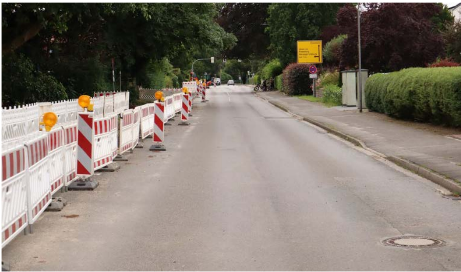
Mittelspannungsleitung Pinneberger Landstraße / Moltkestraße
