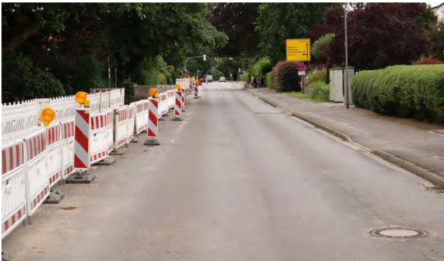
Mittelspannungsleitung Pinneberger Landstraße / Moltkestraße
